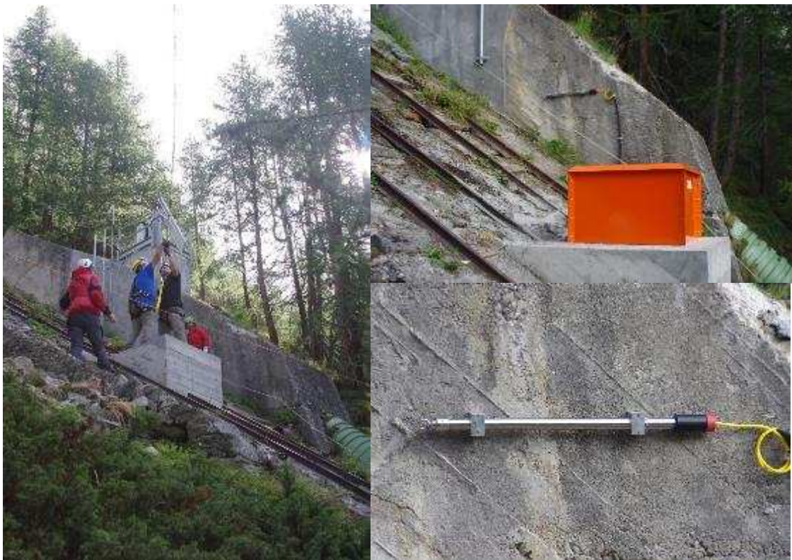
Fasi dell'installazione del sistema DMS; accelerometro sul blocco 16 e box di protezione del sistema.
